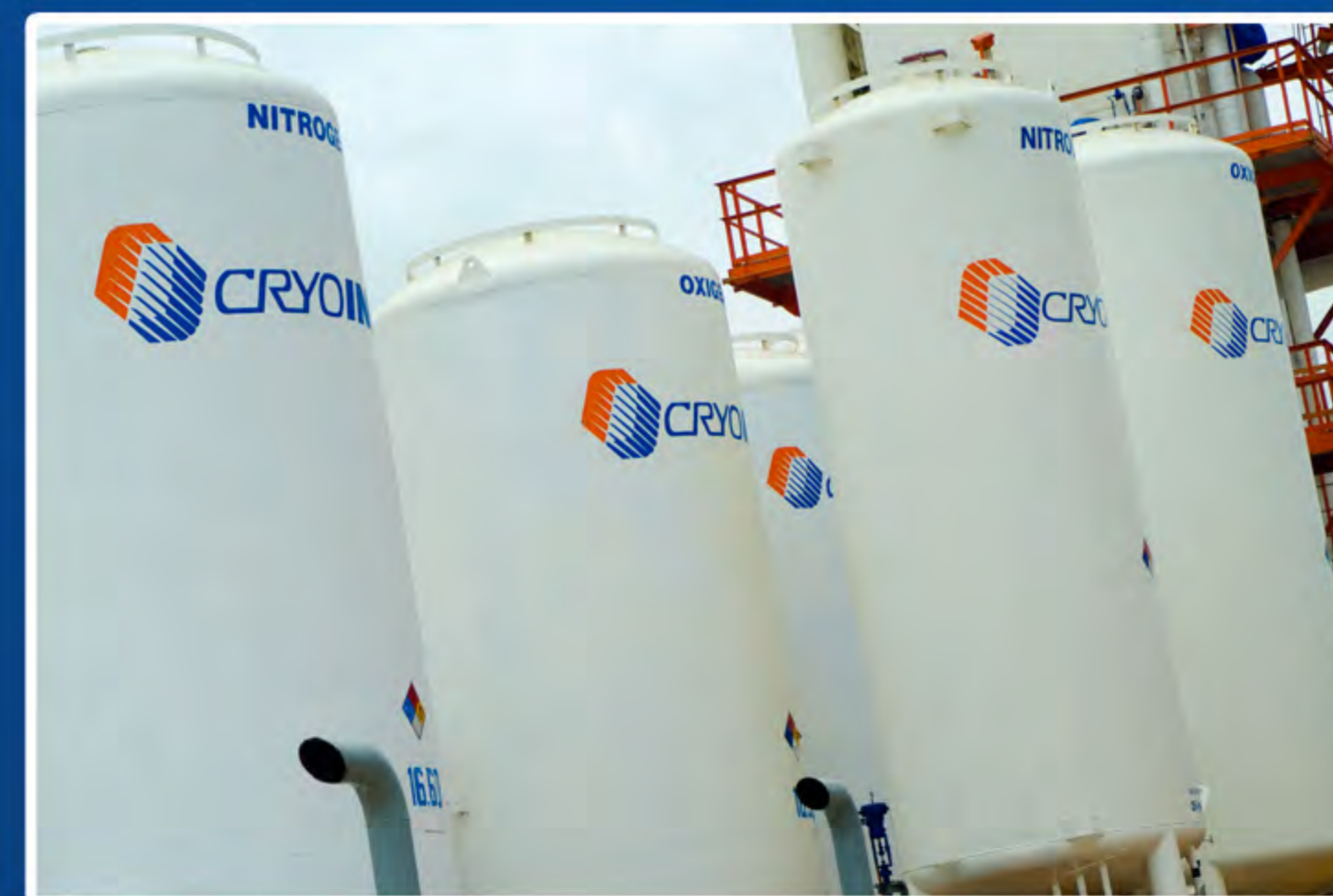
液体备用储罐
