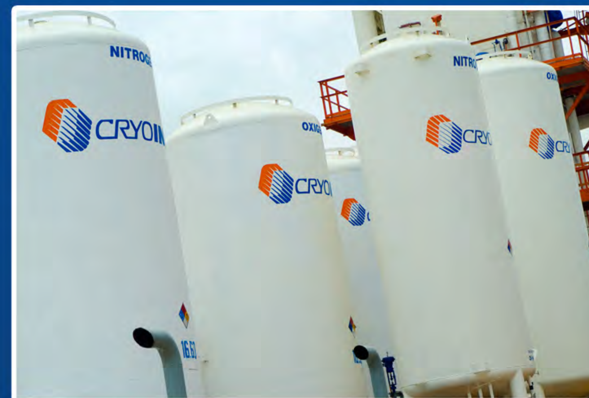
液体备用储罐
